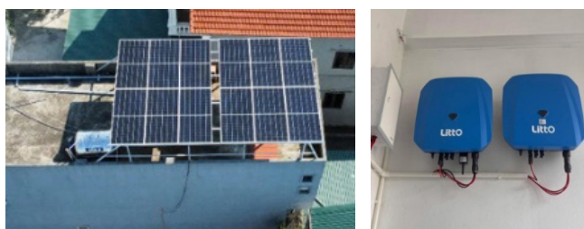
Hình 2: Công trình Điện Mặt Trời áp mái 5kWp
