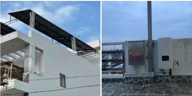
Hình 6: Công trình “Điện Mặt Trời áp mái 5kWp cấp điện cho hộ gia đình”
